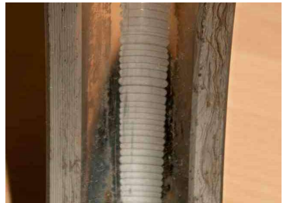
Particolare del cuscinetto danneggiato
